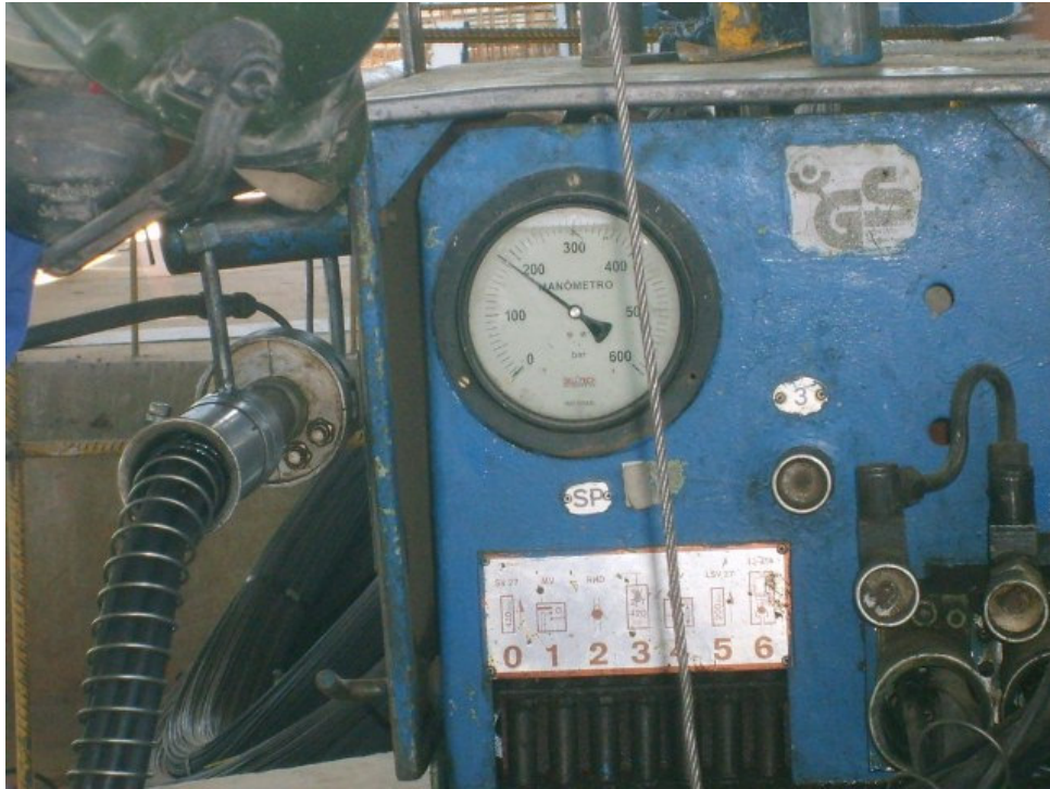
Figura 27 – Manômetro de bomba hidráulica
