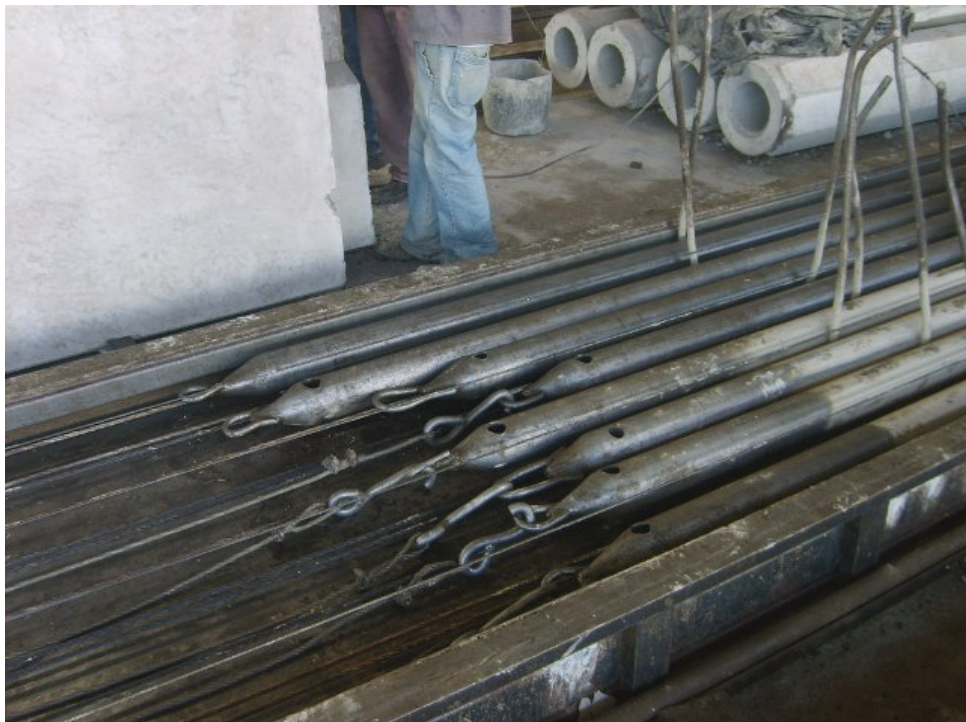
Figura 30 – Extremidade de tubos internos
